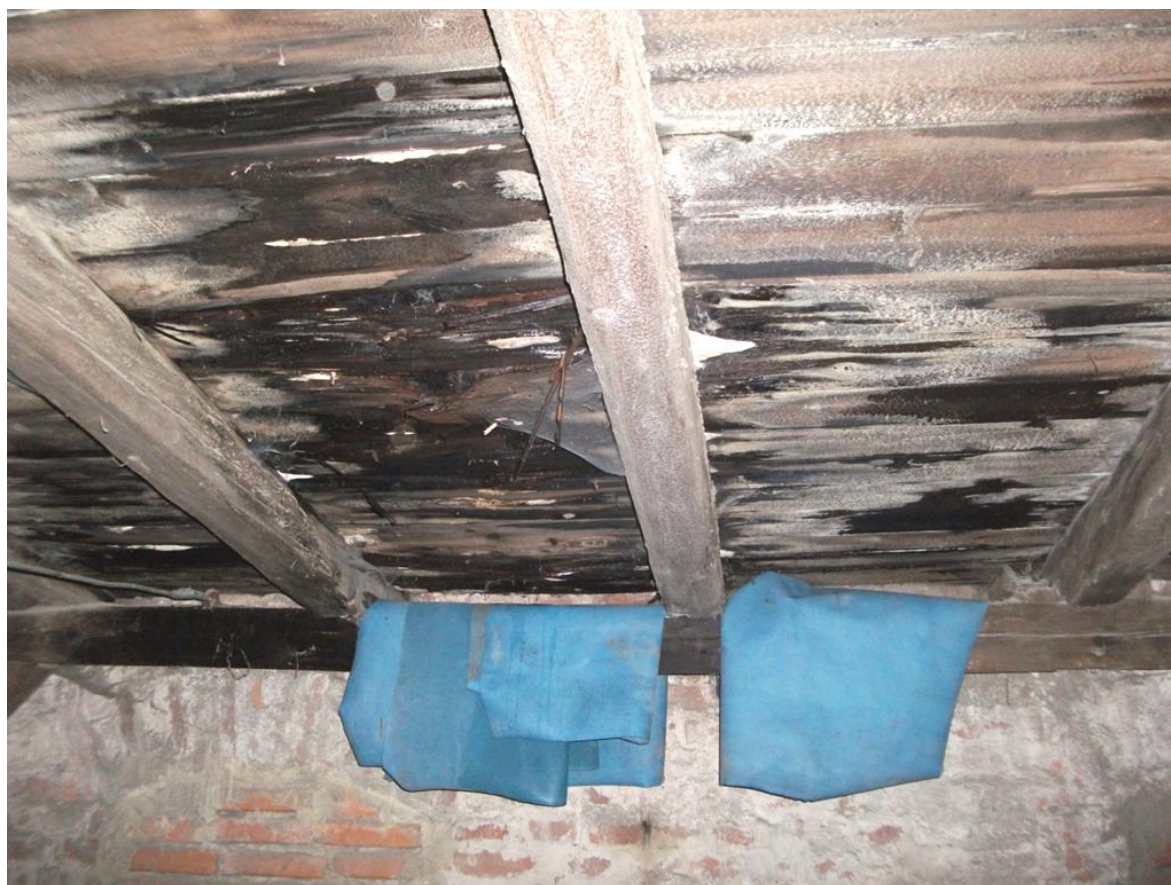
Následek zatýkaní – postupná degradace původního podbití
