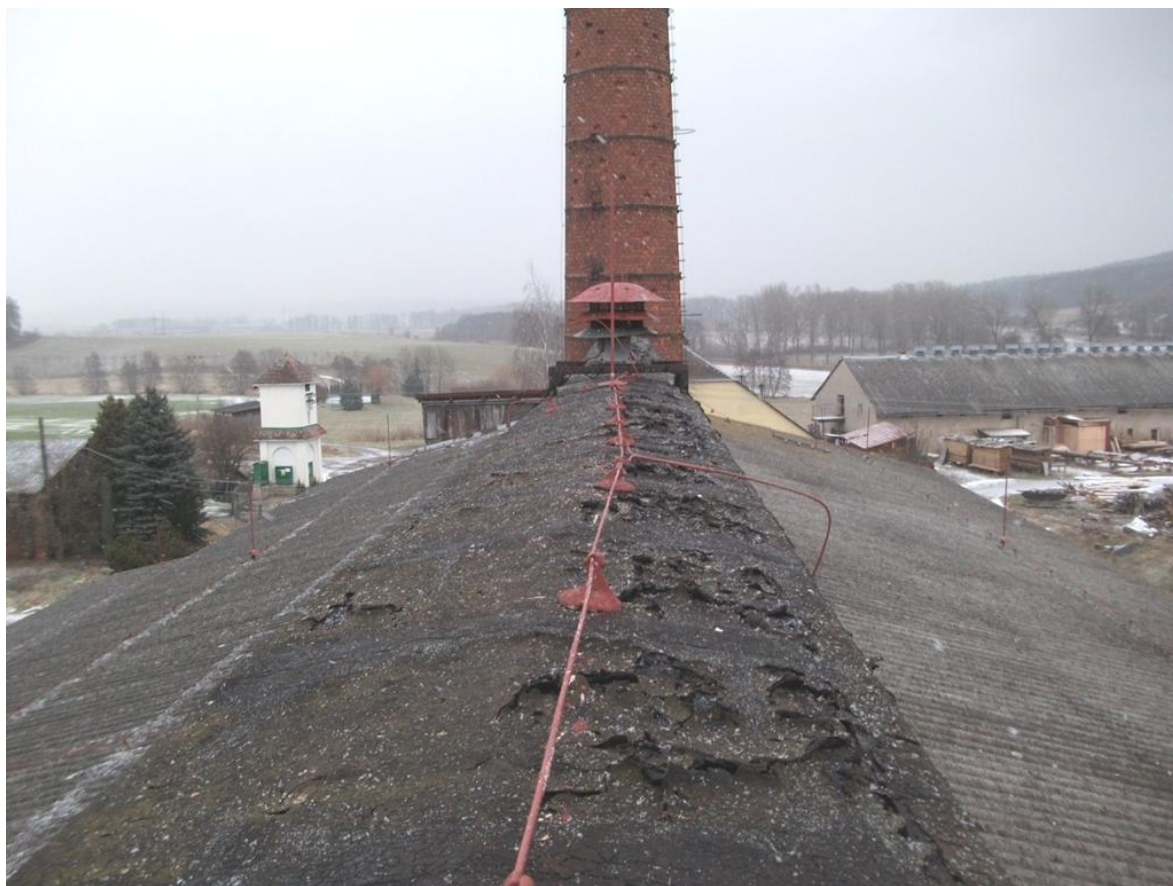
Dezolátní část originální provětrávací nástavby objektu cihelny
