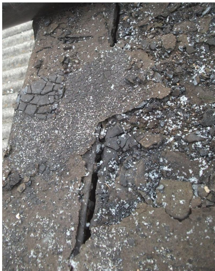
Detail rozpadlé střešní lepenky - otvorů ve střešní krytině
